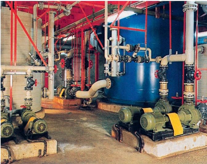
CPDR-Pumpen in der Müll- und Klärschlammverbrennung (Calziumchlorid-Lösung mit Feststoffanteilen)
