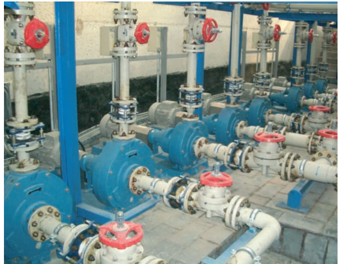
Chemie-Normpumpen Typ CPDR in einer Stahlbeizanlage
