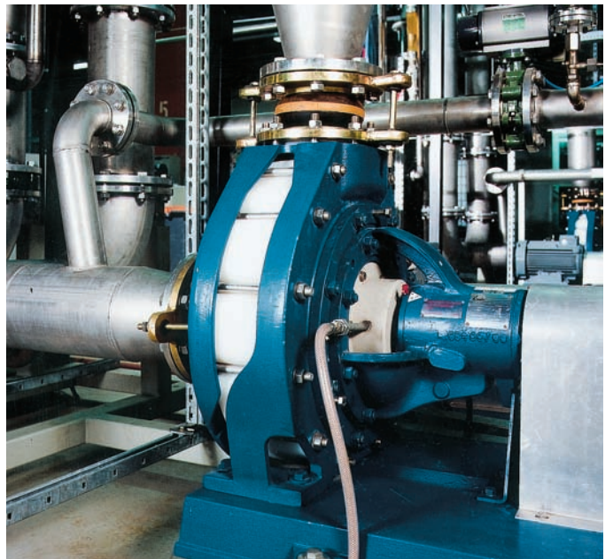
Chemie-Normpumpen aus Kunststoff Typ RCNKu in der Lackieranlage eines großen Automobilwerkes.
